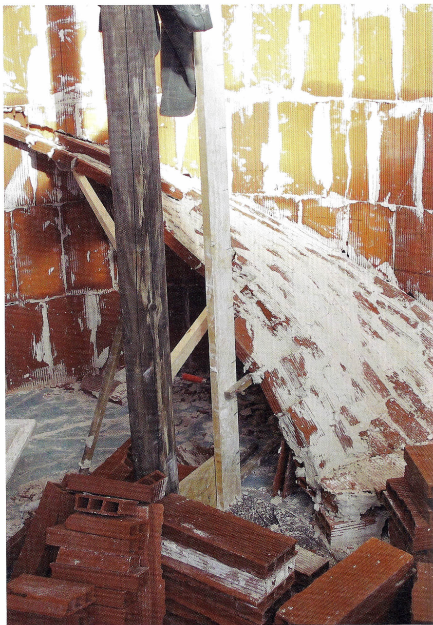
Réalisation d'une volée d'escalier selon le principe constructif de la voûte catalane.
